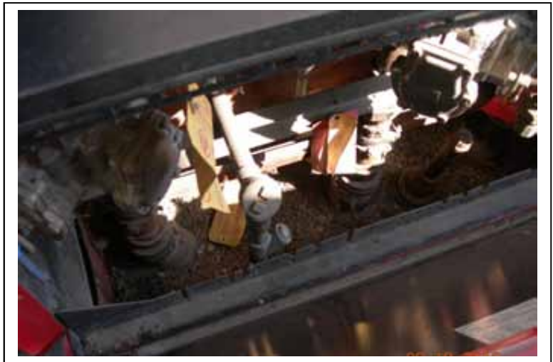
No Sump Bottom
